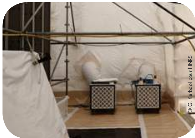
Des extracteurs dotés de filtres à très haute efficacité sont utilisés pour mettre la zone de travail en dépression.
