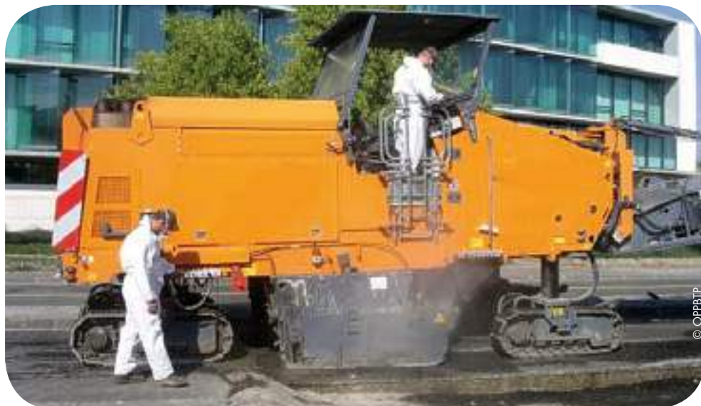
Exemple d'émission de poussières sur engin non équipé de jupes de protection.
