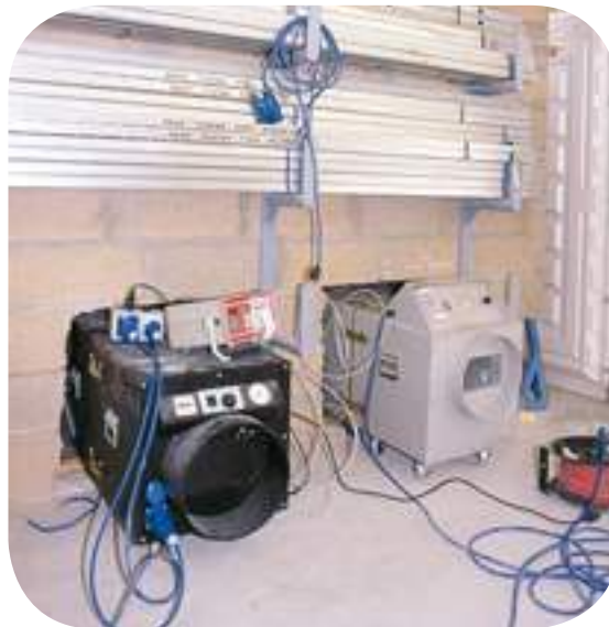
Extraction de l'air filtré et dispositif externe de contrôle de la dépression.
