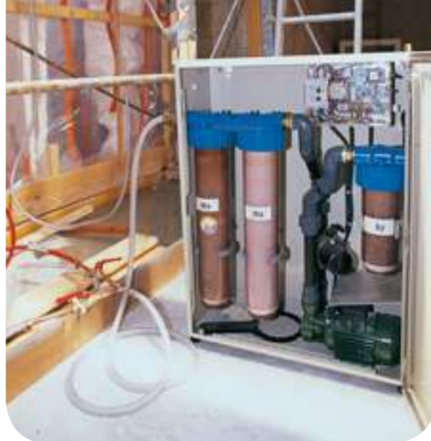
Ensemble de filtration d'eau.
