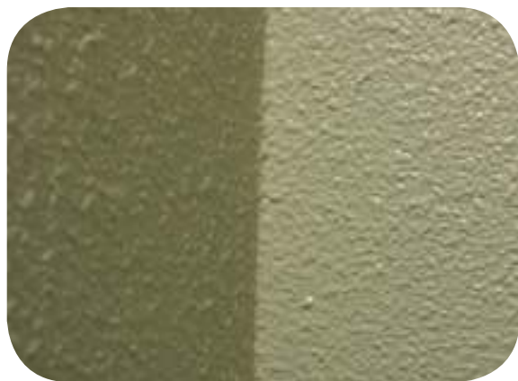
Peinture « gouttelettes » amiantée.
