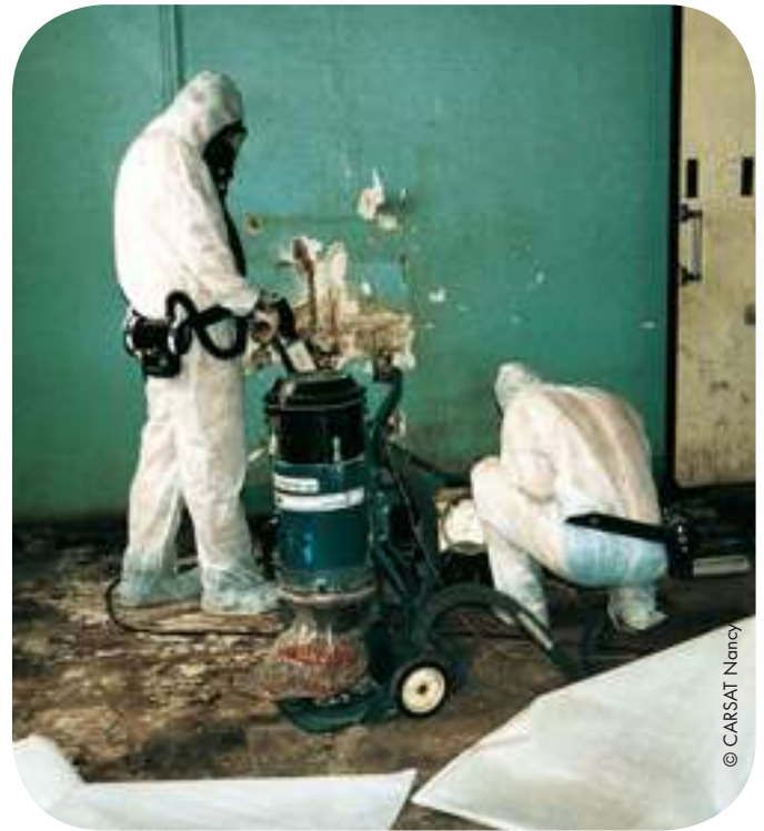
Décollement des dalles sous aspiration.
