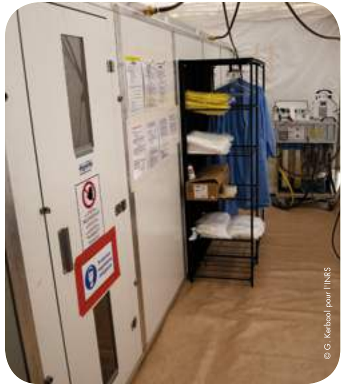
Sas de décontamination à plusieurs compartiments.
