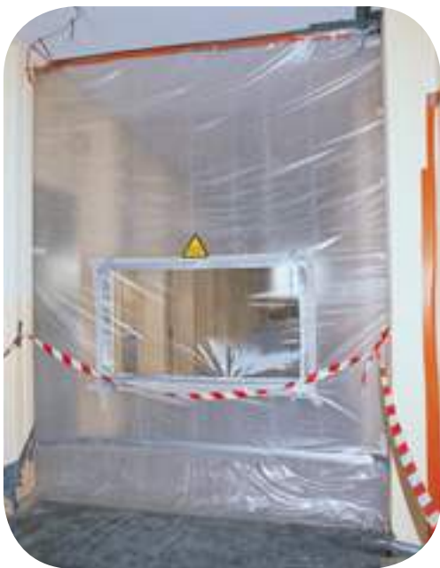
Fenêtre d'observation dans un confinement.
