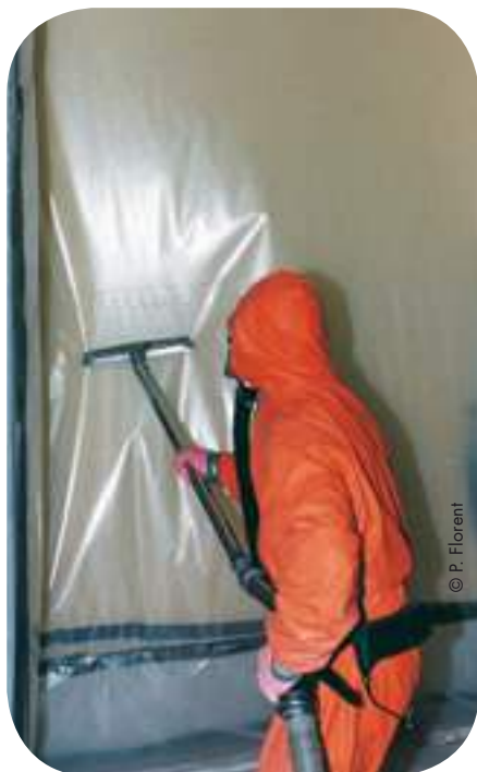
Les films du déconfinement sont dépoussiérés avec soin avant leur démontage.
