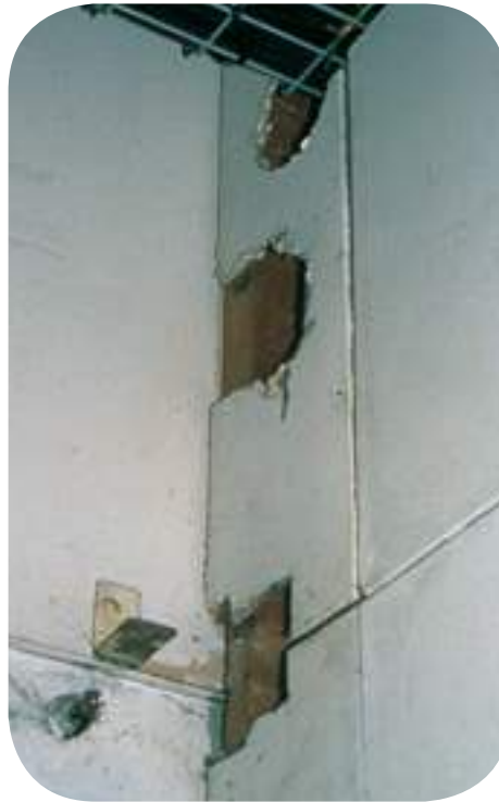
Plaques de carton d'amiante.
