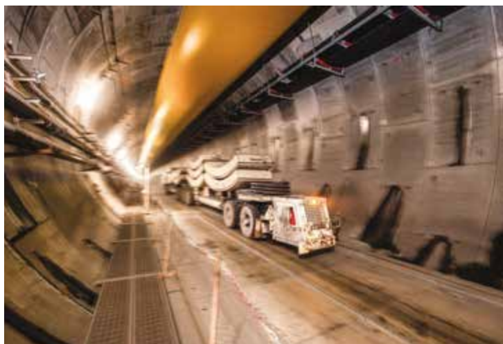
Un train sur pneus semi-automatique a été adopté pour le transport des voussoirs jusqu'au tunnelier. De la zone de stockage jusqu'à ce dernier, il n'y a plus de manutentions.
