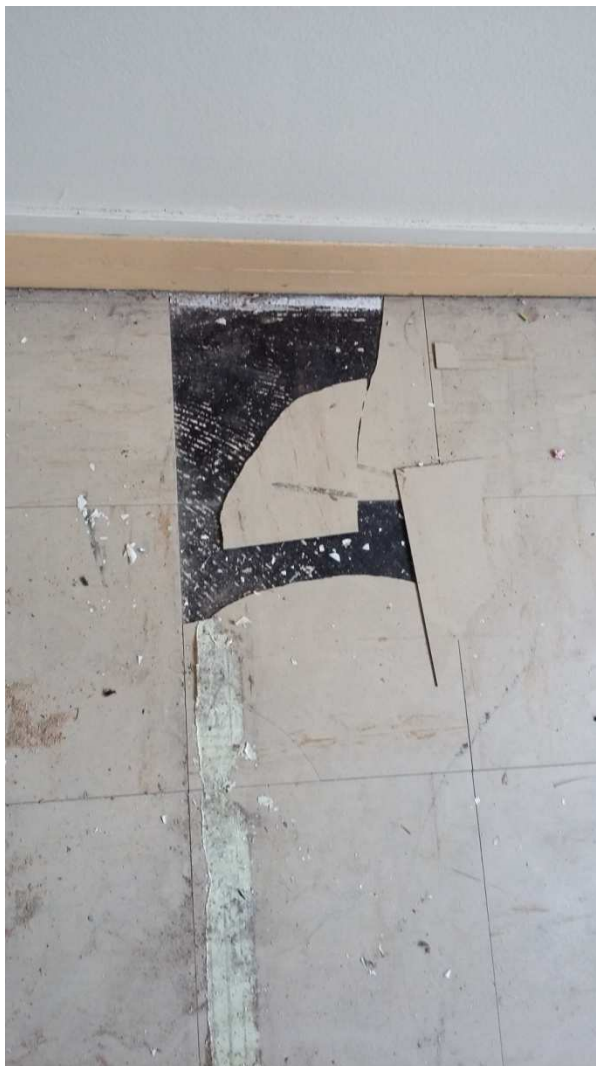
Figure 1 : Site 1- Bâtiment J – Bureau avec DVA beiges dégradées
