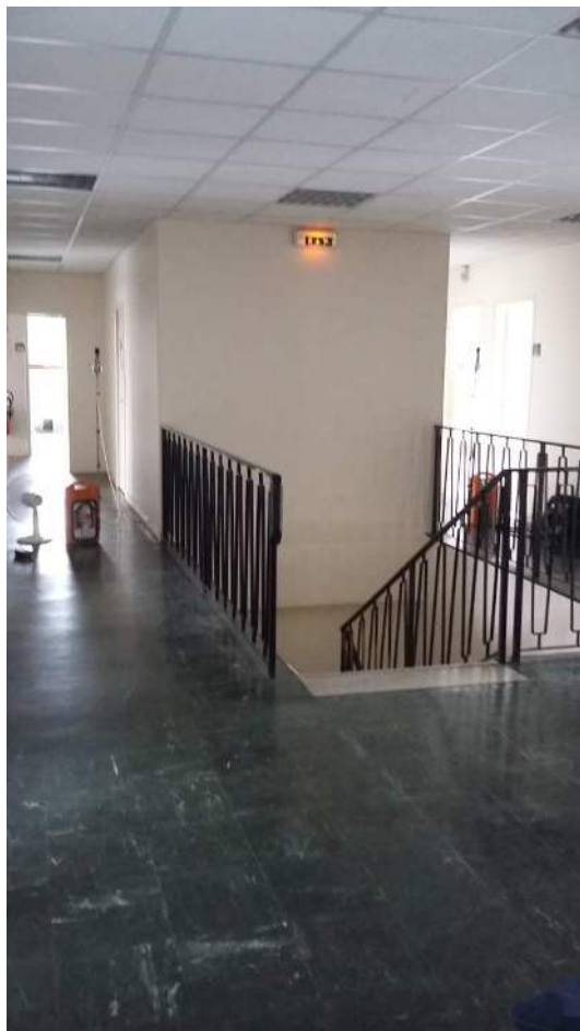
Figure 3 : Site 1 - Bâtiment C - Palier et circulations avec DVA vertes en bon état
